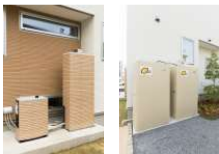
(左)ガスエンジンコージェネレーション (右)LPガス(シリンダー4本)
